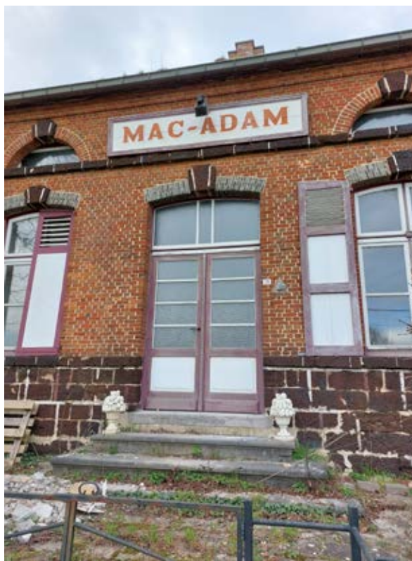
Afb. 4.42 In de voormalige herberg Macadam in Booischot is veel ijzeroer verwerkt. Ijzeroer is donker roestbruin en te herkennen aan een onregelmatig oppervlak.
